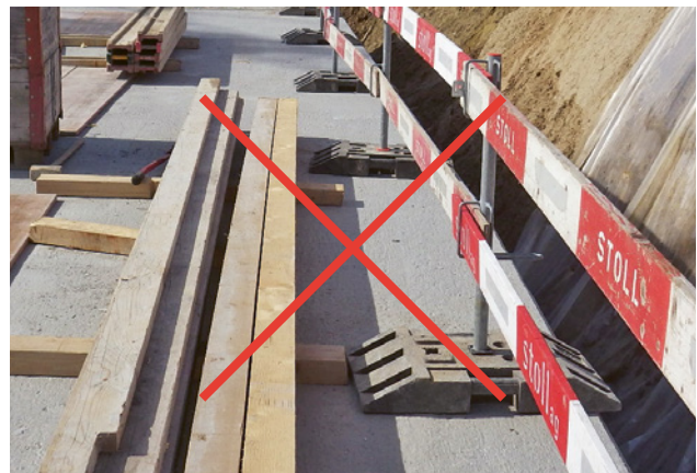
6 Gummisockel für den Seitenschutz an Deckenkanten sind verboten, weil der Seitenschutz leicht kippen kann.
