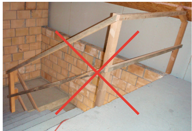
2 Dachlatten als Seitenschutzbauteile (hier im Treppenhaus) sind verboten.
